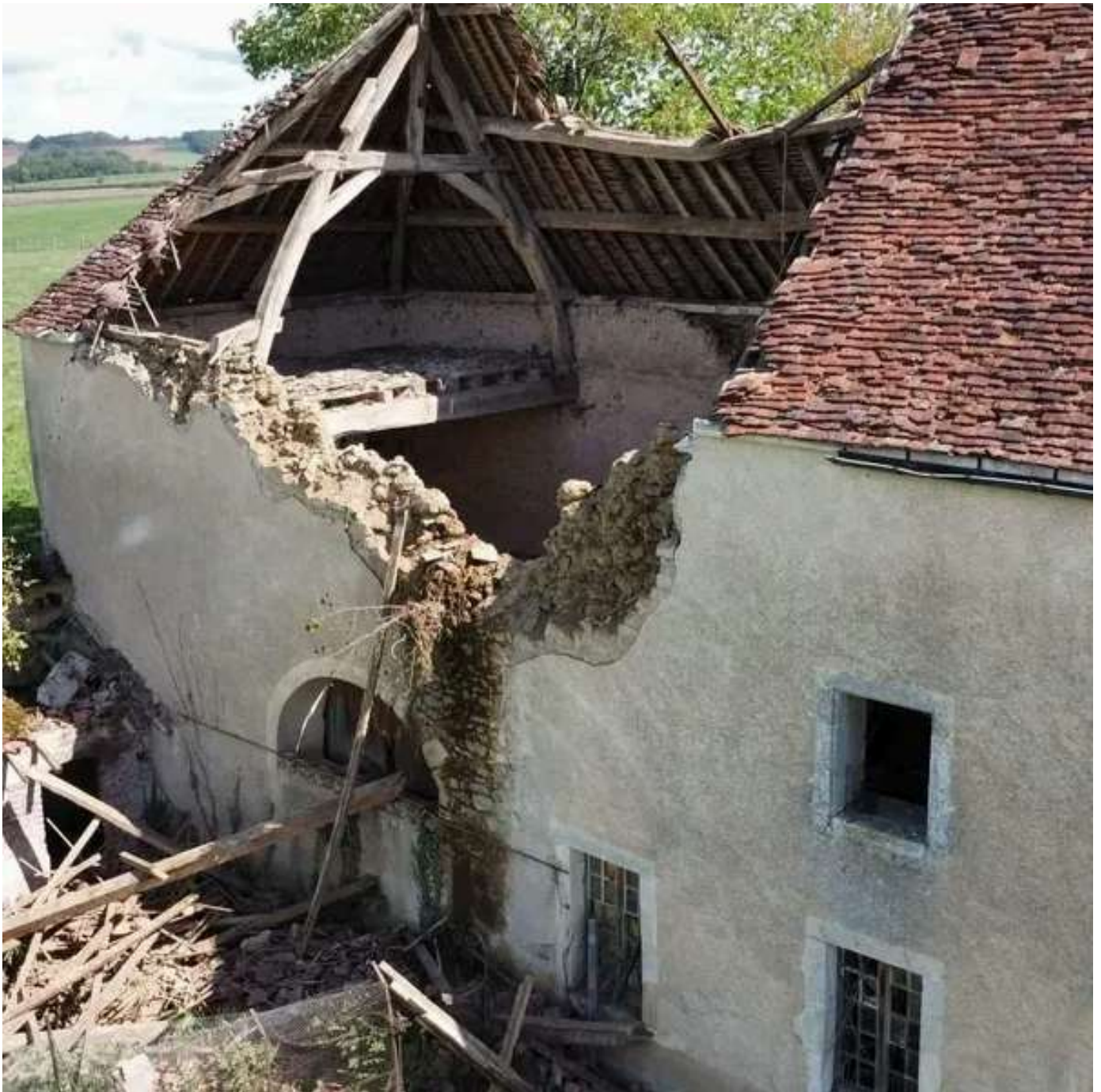
L'étendue des dégâts sur la toiture, après les intempéries du 1er septembre. - Château d'Annéot / Facebook
