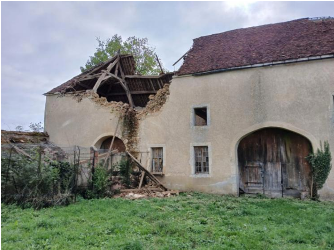
Une partie du toit effondrée du château d'Annéot dans l'Yonne. © Château d'Annéot
